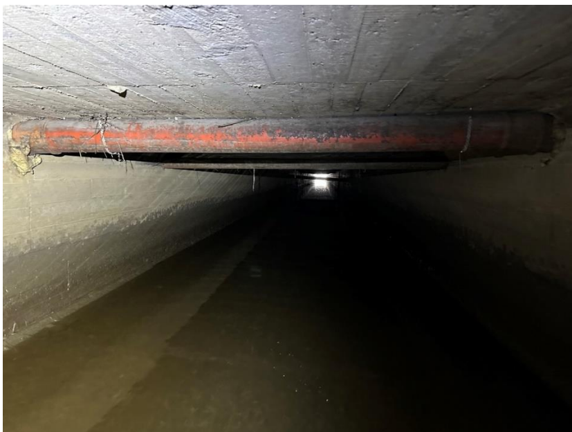
Bilde 23: Kryssende VA-anlegg
