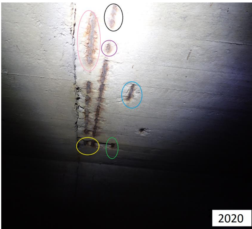
Bilde 13: Skader ved profil 237 i 2020 – ingen synlig skadeutvikling sammenlignet med i 2014
