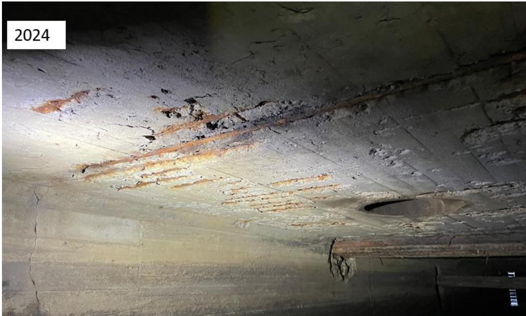
Bilde 8: Profil 175 – Økt omfang av avskallinger sammenlignet med forrige inspeksjon.
