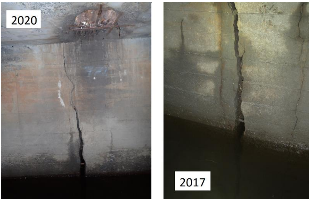
Bilde 3: Sprekk ved profil 763 i 2017 og 2020
