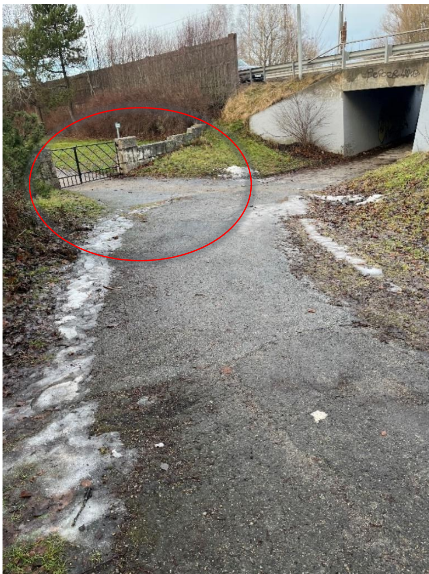
Bilde 36: Setning i asfalten på sørsiden av innfartsåra.
