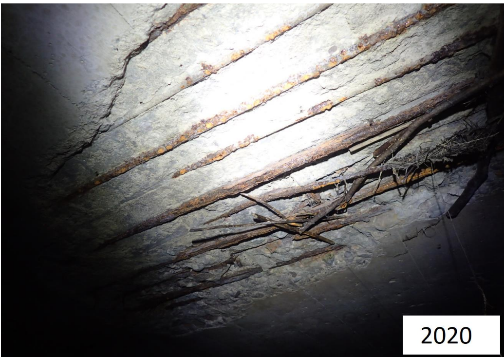
Bilde 15: Skader ved profil 392,5 i 2020 – fremdeles 9 synlige jern, liten skadeutvikling
