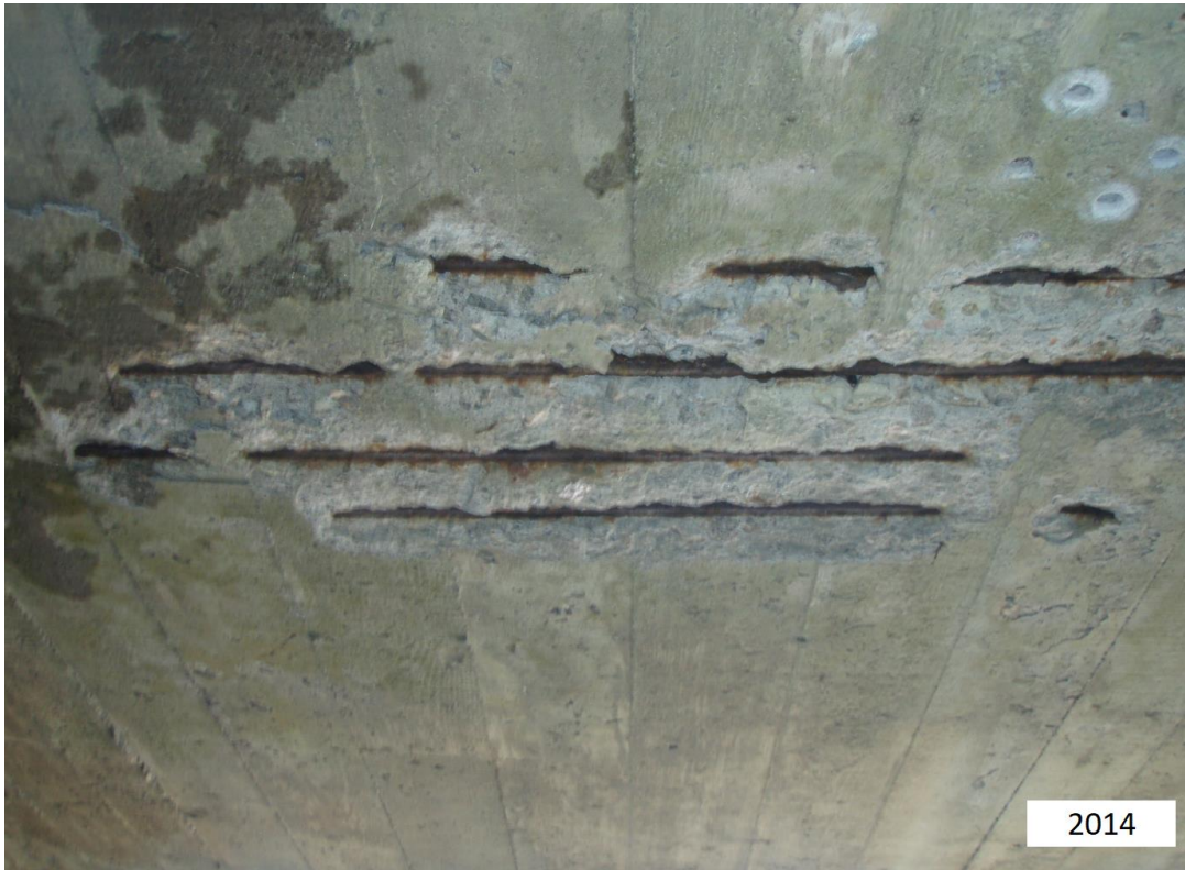
Bilde 6: Skader ved profil 1 i 2014
