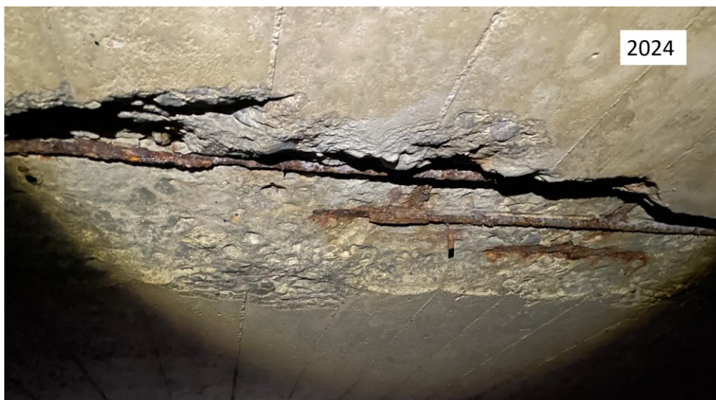
Bilde 11: Skader ved profil 326 i 2024 - Ikke vesentlig utvikling siden 2020.
