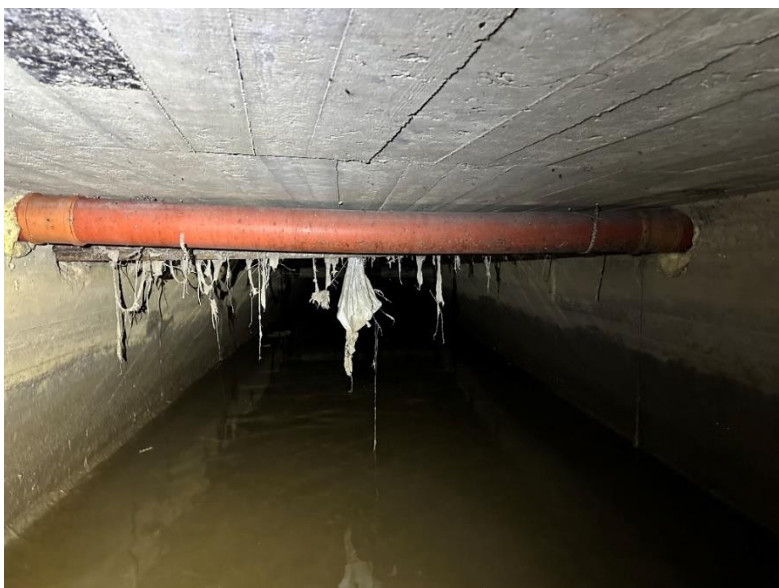
Bilde 25: Kryssende VA-anlegg
