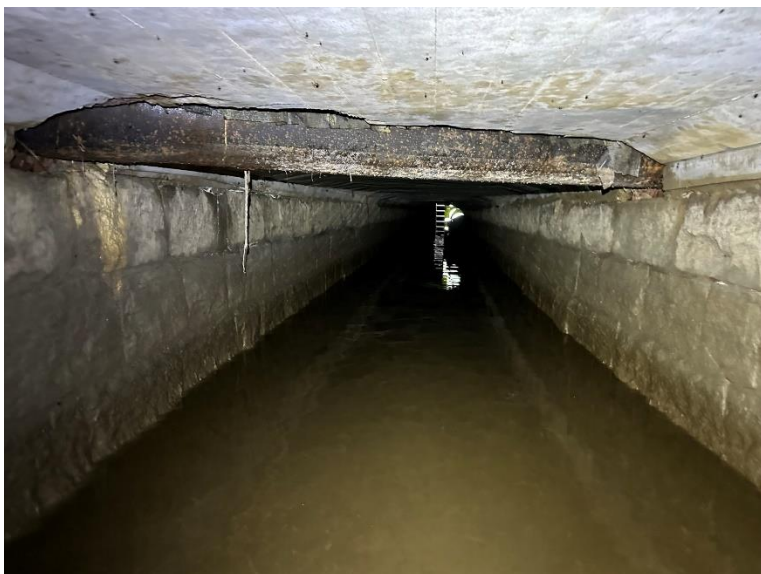
Bilde 29: Kryssende VA-anlegg
