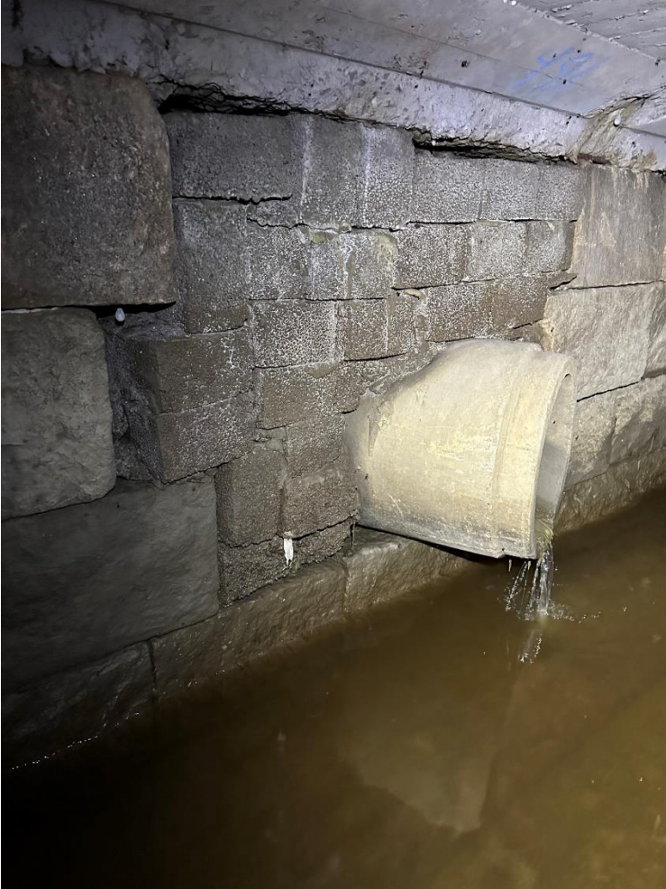
Bilde 31: Kommunalt overløp fra Oredalen (overløp ved Kiwi)
