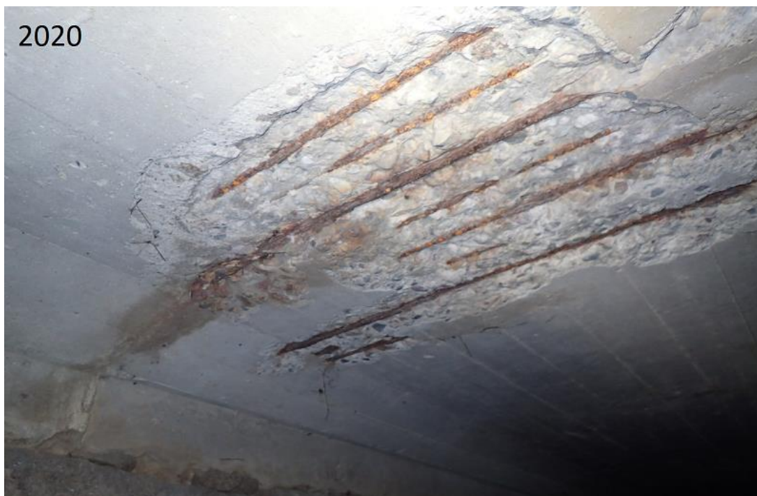
Bilde 18: Skader ved profil 447,3 i 2020 – ingen synlig skadeutvikling sammenlignet med i 2014
