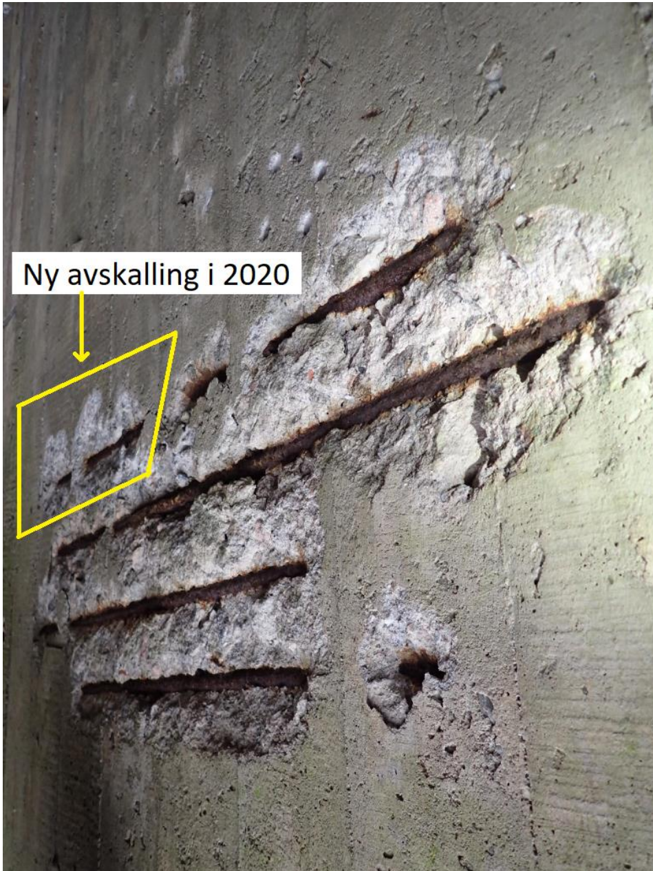
Bilde 7: Skader ved profil 1 i 2020 – ny avskalling sammenlignet med i 2014
