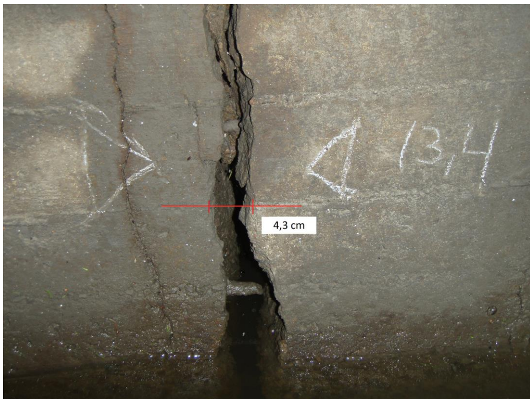
Bilde 1: Sprekk nede – bilde fra 2017 – innmåling fra 2020
