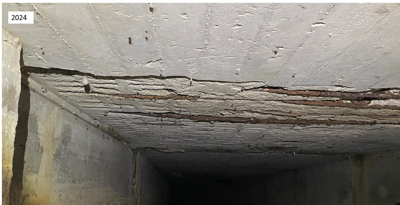
Bilde 20: Skader i tak ved profil 740.
