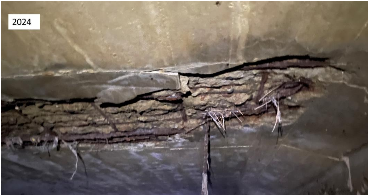
Bilde 16: Skader ved profil 392,5. Noe økt omfang av blottlagte jern.
