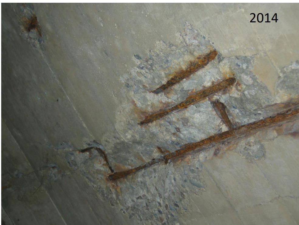
Bilde 9: Skader ved profil 326 i 2014
