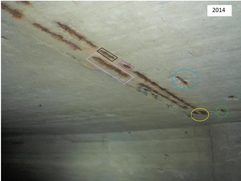
Bilde 12: Skader ved profil 237 i 2014
