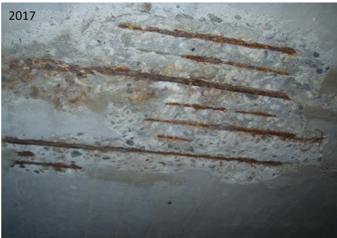
Bilde 17: Skader ved profil 447,3 i 2017
