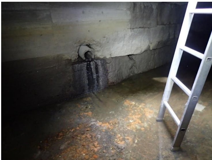
Bilde 28: Utløp spillvann fra flermannsbolig ved profil 260 (bilde fra 2020).
